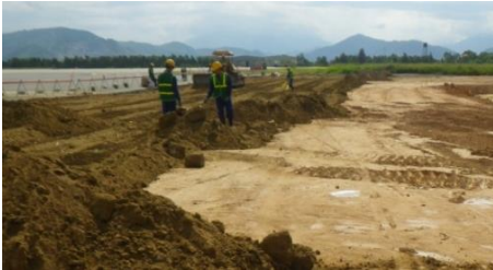
Lấp lại đất ở Khu Pha trộn và Chuyển tải trước đây (Ảnh: CDM Smith)
